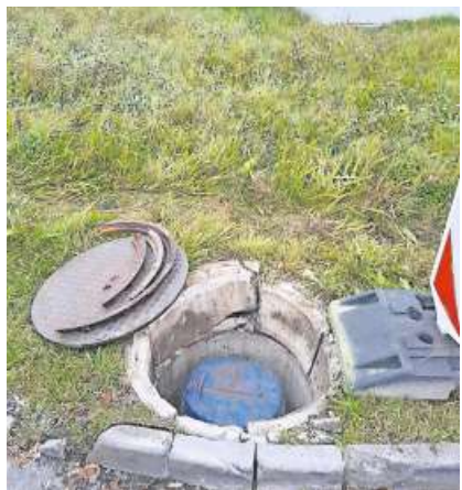
Defekter Schacht: Der Metallring ist gebrochen. Bild: PD
